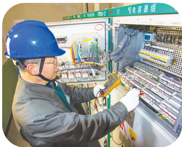
检查高压开关柜
