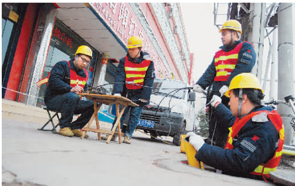
2月15日,中国联通南阳分公司公众客户响应中心安排人员抢修光缆,保障用户通信需求。 本报记者 张戈 摄
