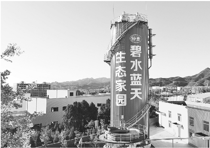
仲景大厨房污水处理中心
