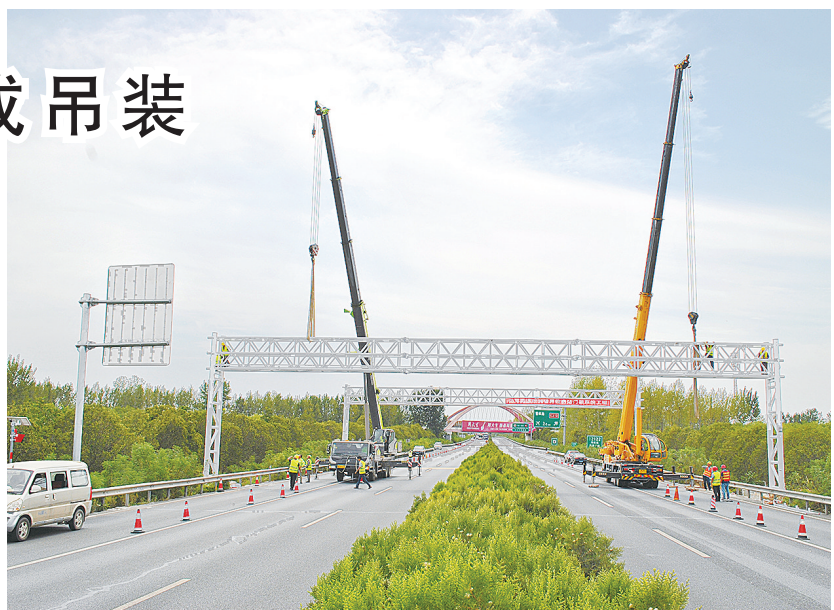
横跨高速公路的ETC门架 全媒体记者 李佩佩 摄
