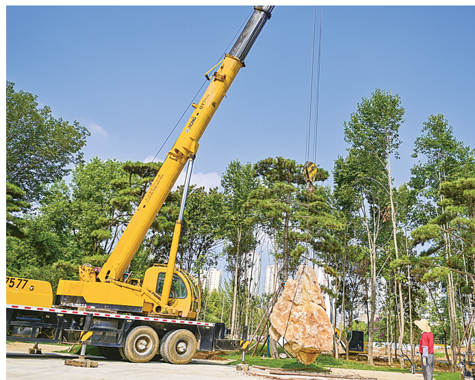
8月7日，中伯公园施工现场，工作人员顶着烈日转运巨型景观石。中伯公园项目备受市民关注，连日来，建设工作者战高温、斗酷暑，赶进度，全力以赴推进项目建设。 本报记者 张峰 摄
