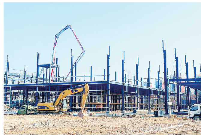
正在施工的广州白云山中药饮片合作项目(倍益健艾草产业园)。
