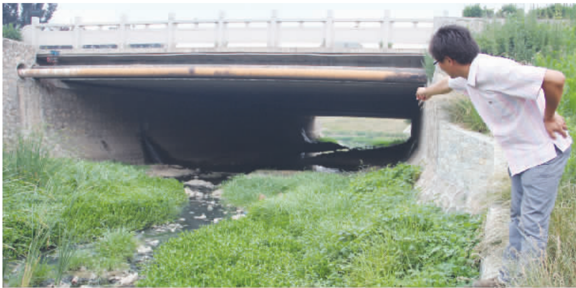
邕河张衡路桥下的排污口
