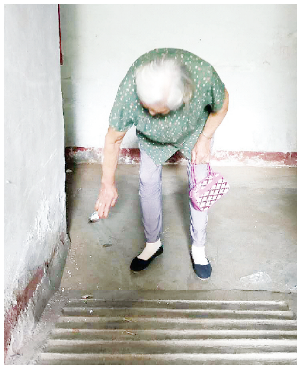
漏水的地下室 本报记者 王冕 摄
