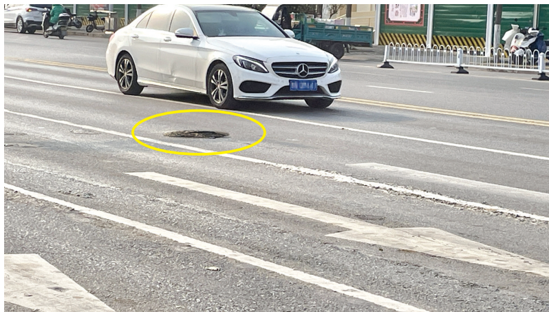
路上的水泥疙瘩(如图所示)
