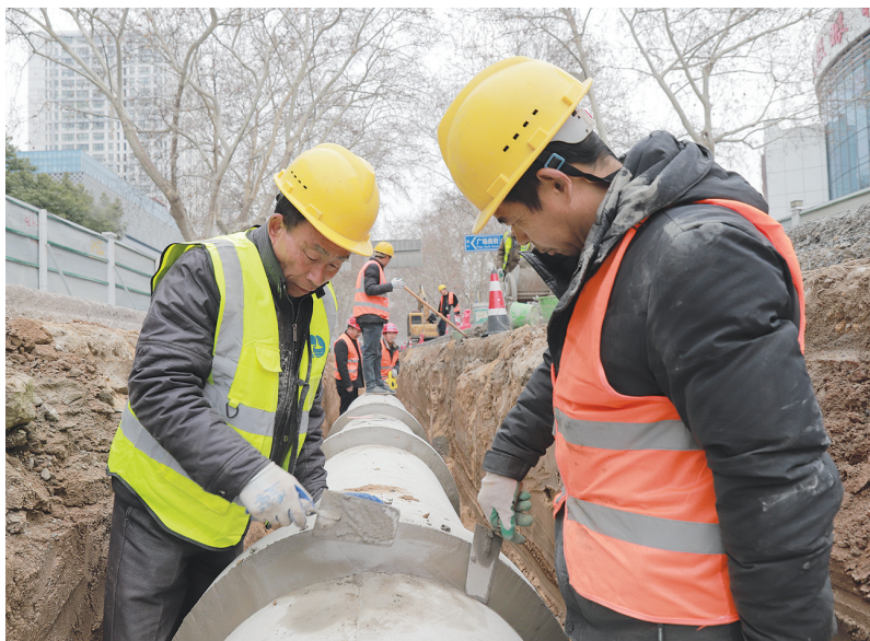
管道密闭操作 本报记者 周梦 摄
