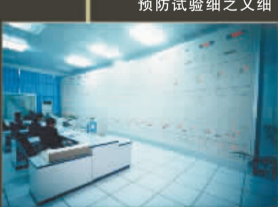
调度中心保障供电
