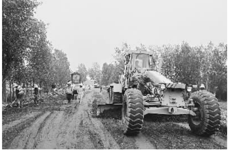
今年以来，宛城区把农村公路建设作为服务农村经济社会发展的一件实事狠抓落实。目前，全区投资5000余万元的农村公路建设项目已完成70%以上。图为工人们正冒着酷暑紧张施工。①7
