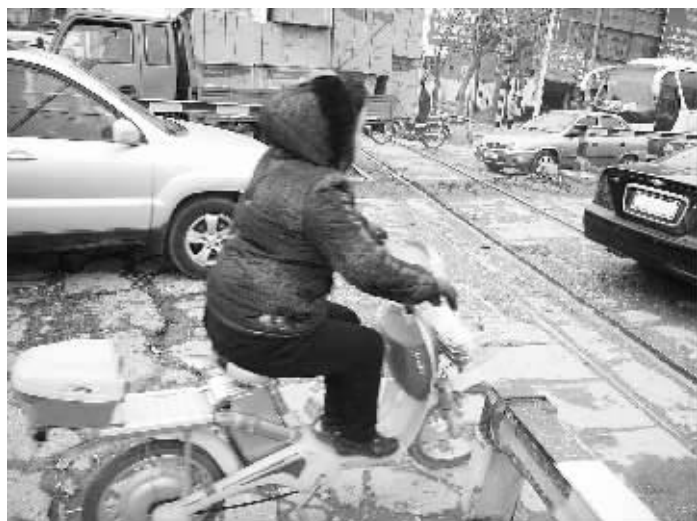
铁路护栏伸入道路,路面破损 本报记者 王冕 摄
